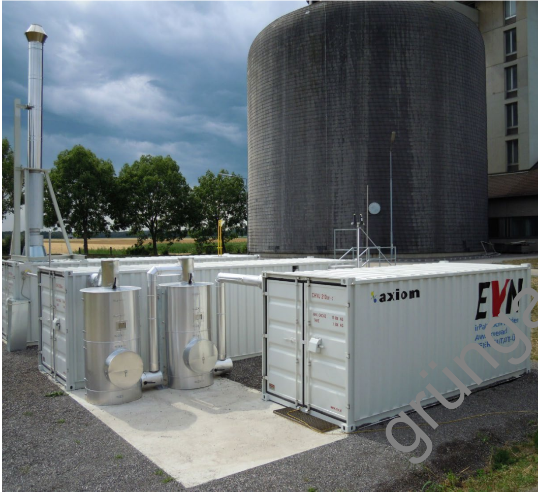
Aufbereitungsanlage bei der Kläranlage Wiener Neustadt (seit 2011)
